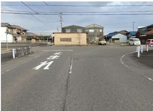
道路の白線が消えてしまっていた。
